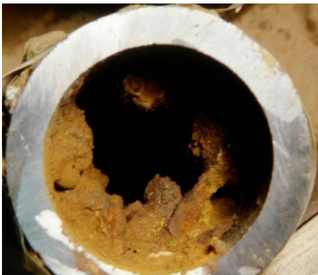
Bild 65. Frätningar på ett gjutjärnsrör från korrosion.
