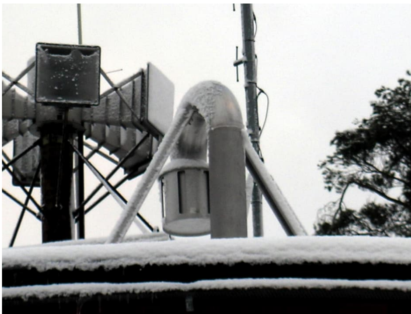
Bild 87. Vattenreservoarer ska vara täta och inloppsluften ska filtreras. Det rekommenderas inte att en vattenreservoar är ett fundament för apparater så som visas på bilden.
