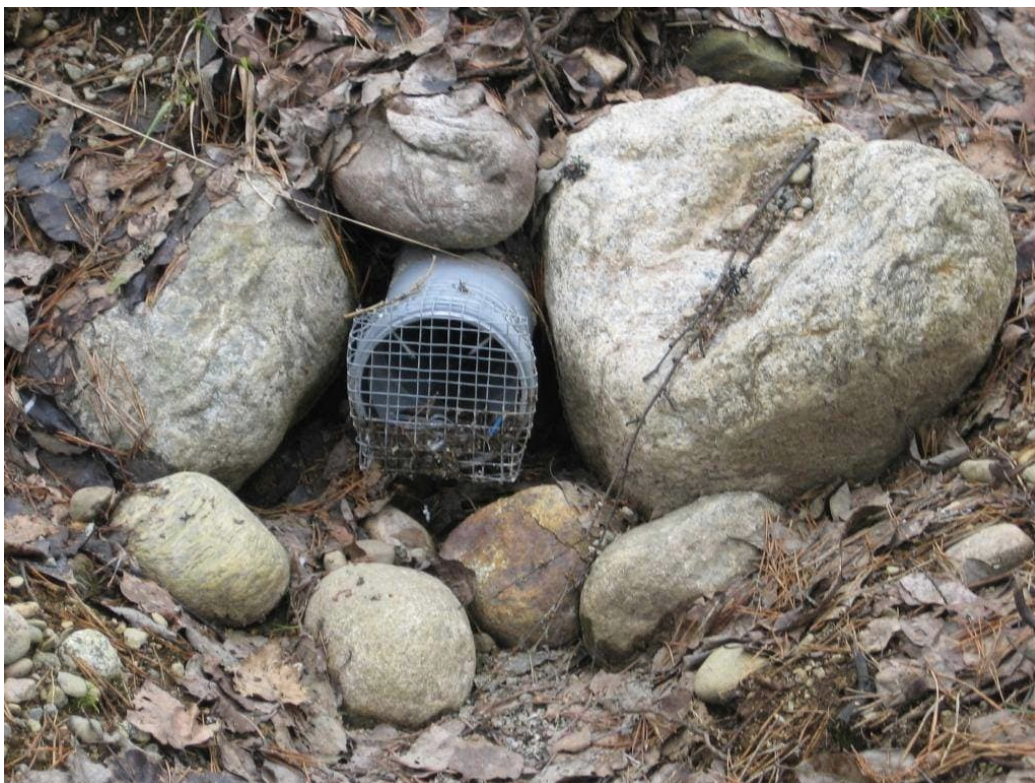
Bild 8. Det kan via dräneringsröret strömma smält- och översvämningssvatten in i brunnen, om återflödet inte är förhindrat. Maskvidden på skyddsnätet på bilden är för stor för hindra smådjur från att tränga in i dräneringsröret.
