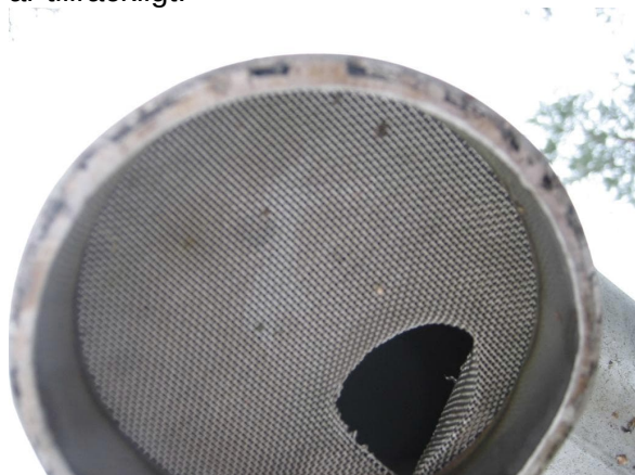
Bild 10. Smådjursnät på ventilationsrör till reservoarer och brunnar ska kontrolleras regelbundet.
