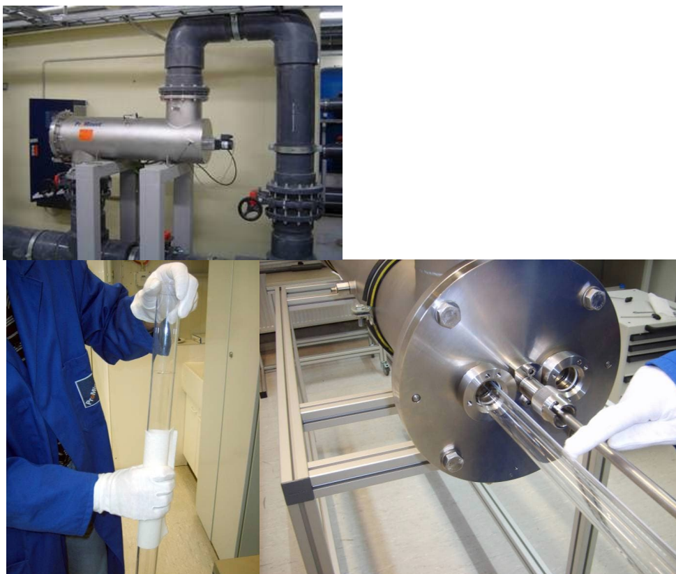
Bild 54. Ett UV-aggregat då det installerats hos ett vattenverk. Skyddsroren kring UV-aggregatets lampor kräver rengöring.
