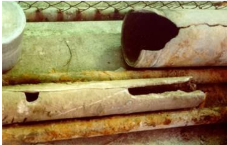
Kuva 4.5 Asbestisementtiputkia, joiden käyttöikä on päättynyt (Pilcher 2004)
