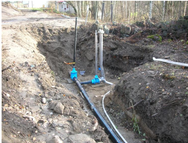
Kuva 2.3 Paloposti, jossa automaattinen pystyputken tyhjennys ja kuivatus salaojaputkella (Sykli 2010)
