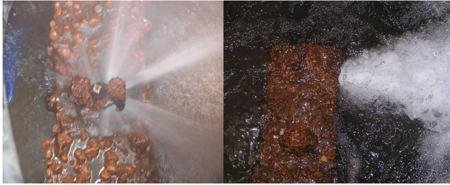
Kuva 4.1 Vuotojen syinä korroosio ja asennusvirhe tonttijohdossa (Pilcher 2005)
