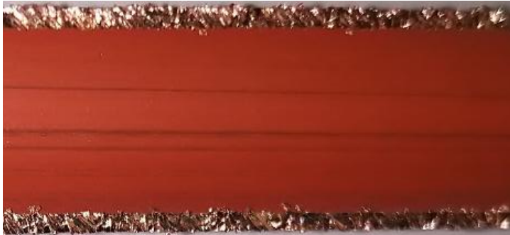
Kuva 2. Käyttämättömän kupariputken sisäpinnalla tummia raitoja (kupariputki suora kova R290, tyyppihyväksytty käyttövesiasennuksiin Suomessa). Kuvassa punainen väri on korostunut, todellinen värisävy näkyy kuvassa 1 b) oikea putki.
