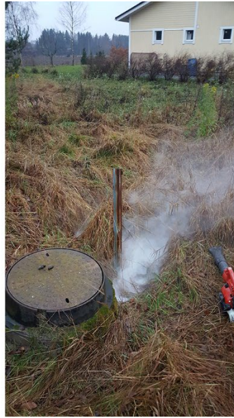
Runkoviemäriin puhallettu savu purkautuu tarkastuskaivon avoimista saumoista.
