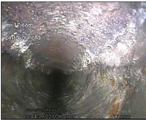
150 mm BET, vähäinen pintavaurio, klo 0–12
