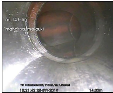
110 mm muovi, liittymä, tonttviemäri liittyy runkoviemäriin (ns. piiloliittymä)
