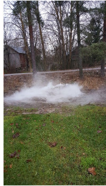
Runkoviemäriin puhallettu savu purkautuu tarkastuskaivosta ja paljastaa viemärikartasta puuttuvan tonttviemärin.
