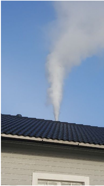
Tonttviemäriin puhallettu savu purkautuu tuuletusviemäristä katolle.
