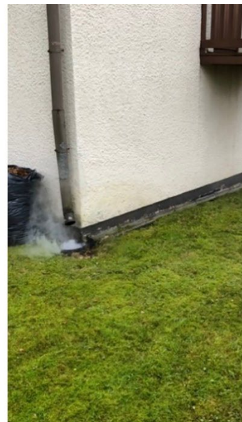
Tonttviemäriin puhallettu savu purkautuu kattovesisuppilosta.
