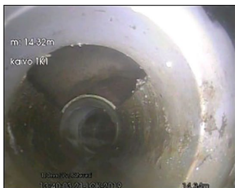
110 mm muovi, tarkastuskaivo
